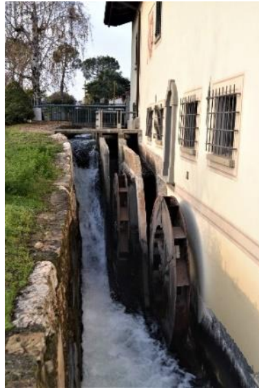
Impianto idraulico del Mulino del Bosco
